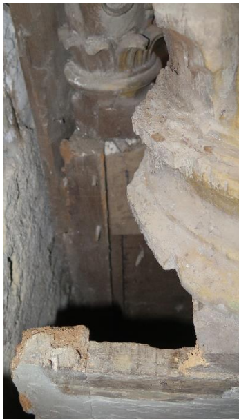
Vue de l'état de conservation du support de la colonne avant intervention
